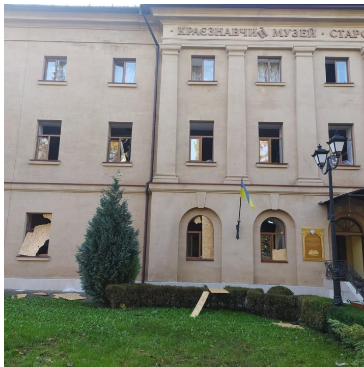
Рис.1.12. Старофлотські казарми після пошкодження. Головний фасад
