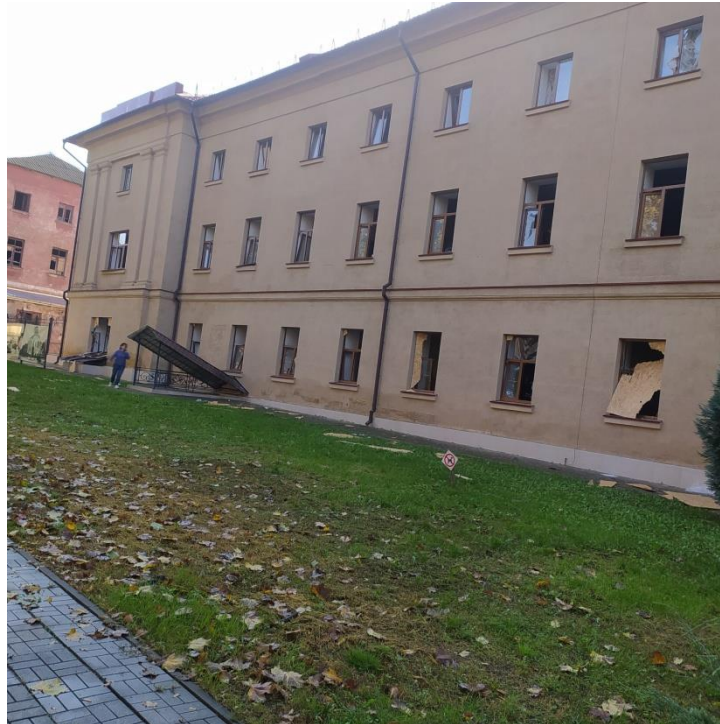
Рис.1.13. Старофлотські казарми після пошкодження. Головний фасад
