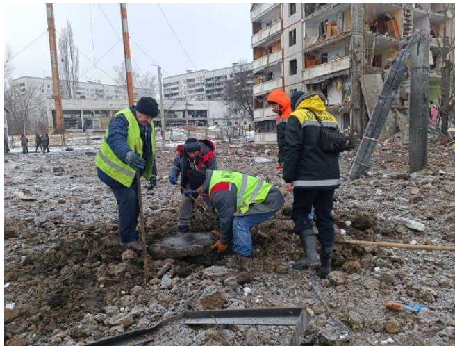
Рис 1. Руйнування каналізаційного колектору у м. Харків в січні 2024 року (фото - https://www.sq.com.ua/ )
