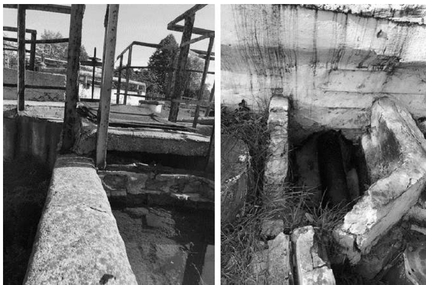
Рис. 1. Стан будівельних конструкцій діючих міських очисних споруд
