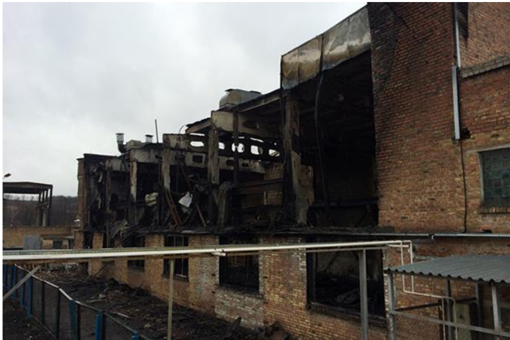
Рис. 1.2. Обвалення з/б конструкцій заводу в результаті пожежі, Ржищів
