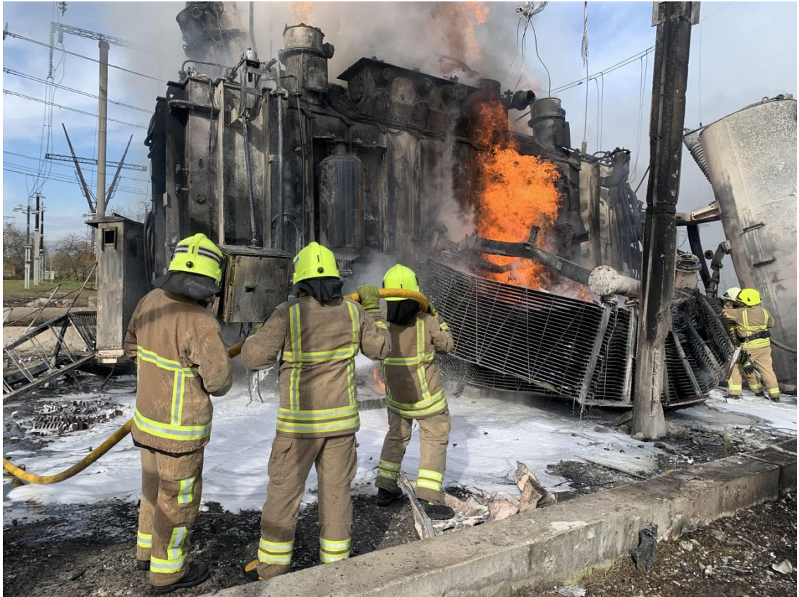
Рис. 1.1. Вид трансформатору після пожежі
